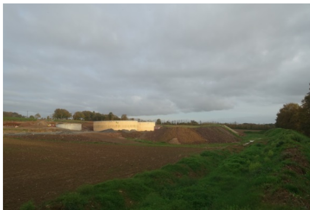
Photo du méthaniseur construit sans respecter les délais de recours
